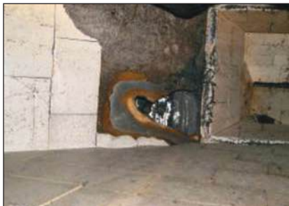
Rupture de la goulotte revêtue de tuiles après quatre mois, avant le rebouchage.
