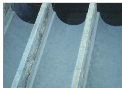
Les trois conduites de pompe revêtues avec de l'ARC 791
